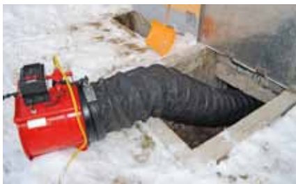
Das expositionsgeschützte Be- und Endlüftungsgerät im Einsatz.
