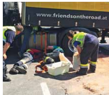
Mit Dichtkissen und Spanngurten wurde das Leck beim Tank provisorisch abgedichtet.
