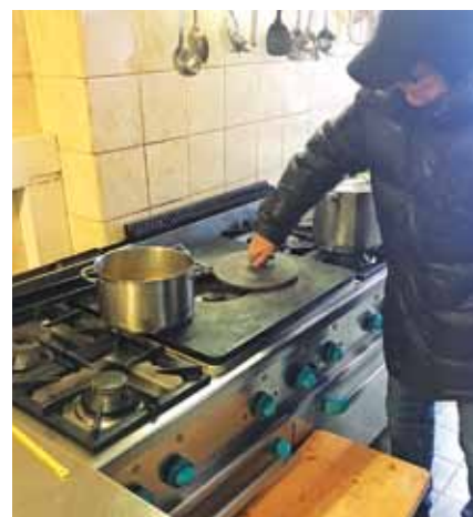
Im Bereich der Gastronomieküche kam es zum CO-Austritt.
