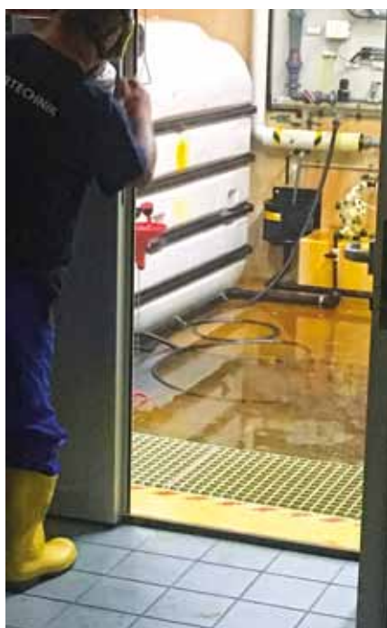
Situation bei der Ersterkundung.
